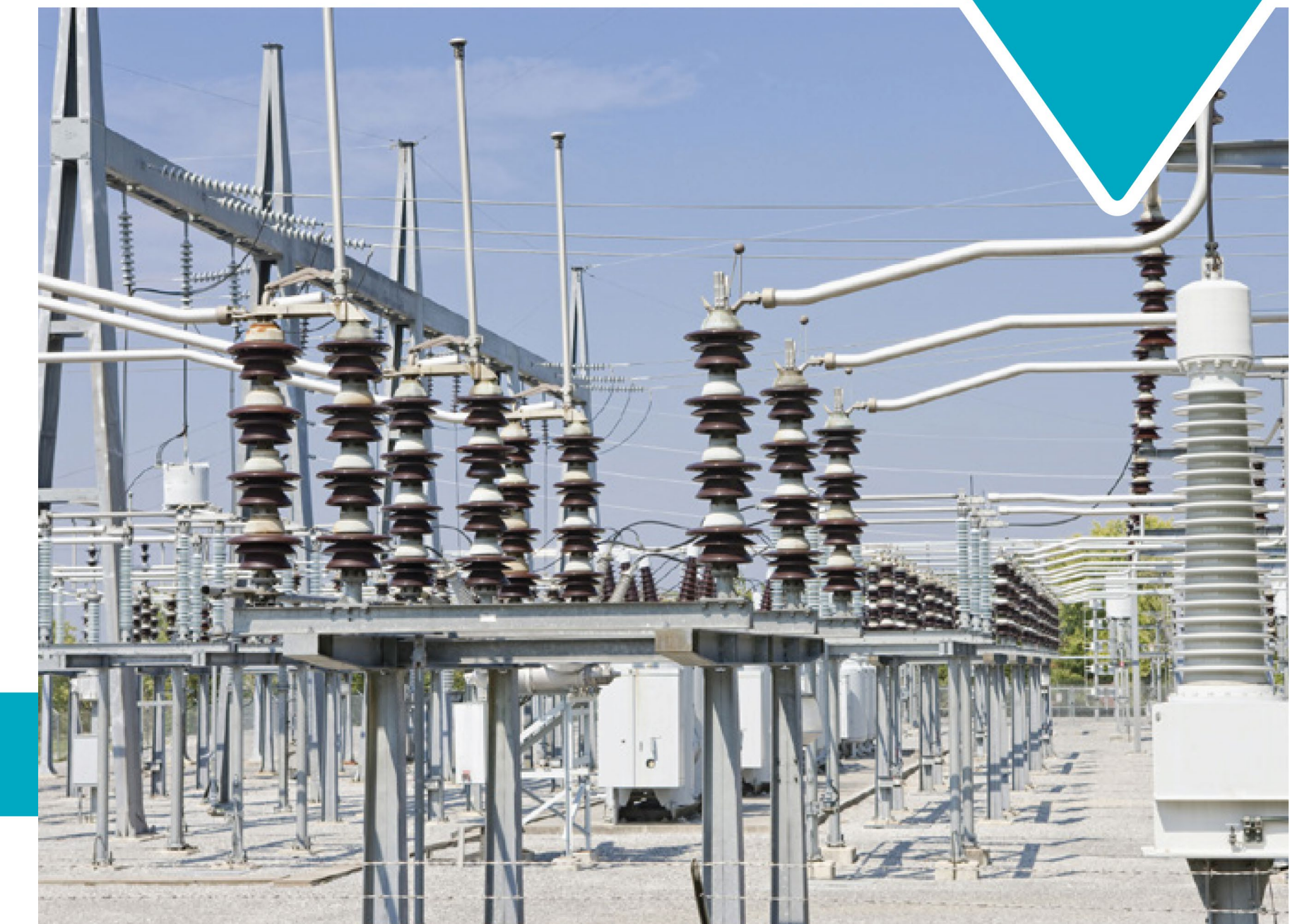
Distribution Substation Subestación de distribución
