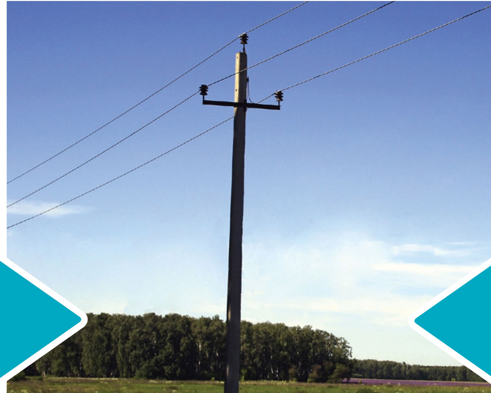
Distribution Lines Líneas de distribución
