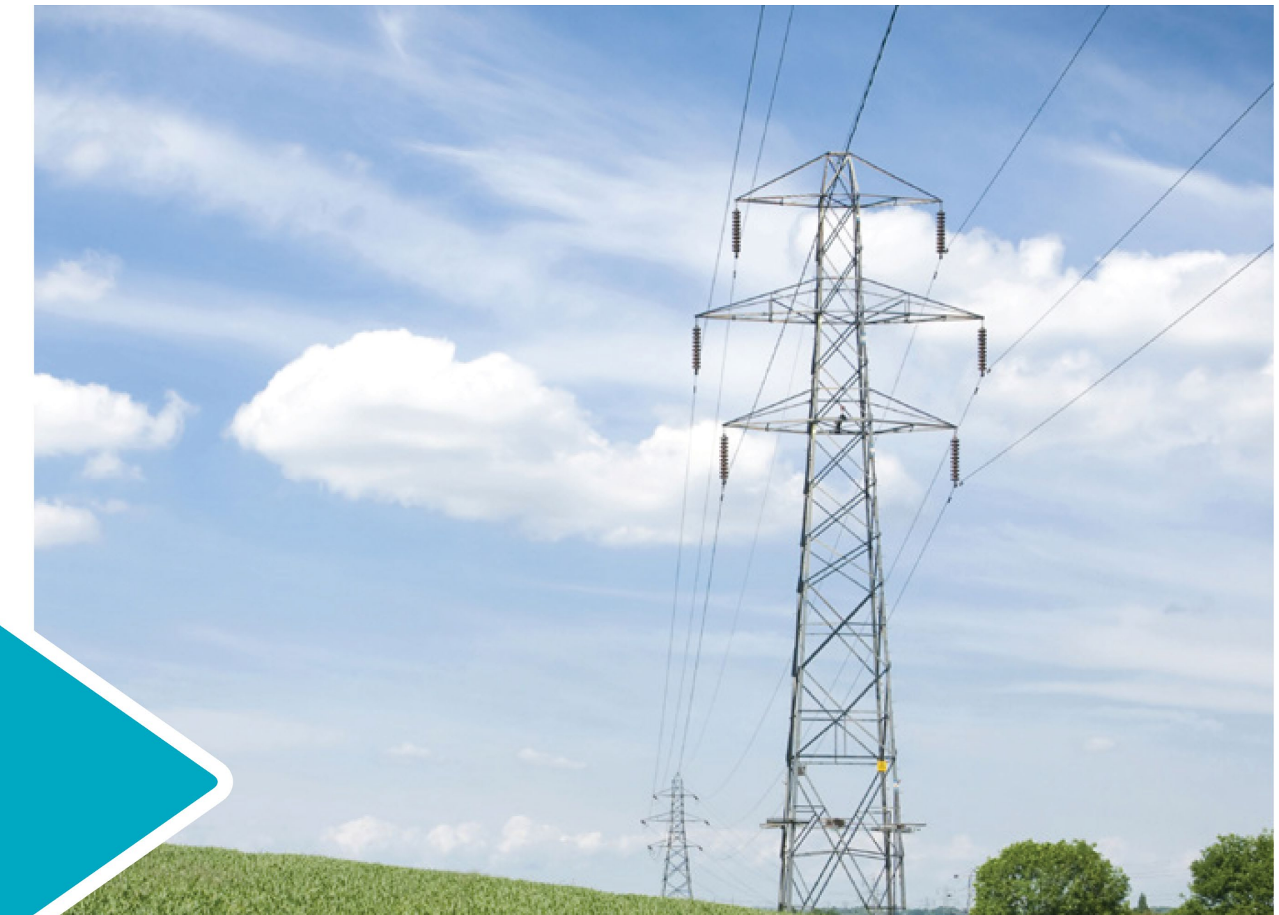
Transmission Lines Líneas de transmisión
