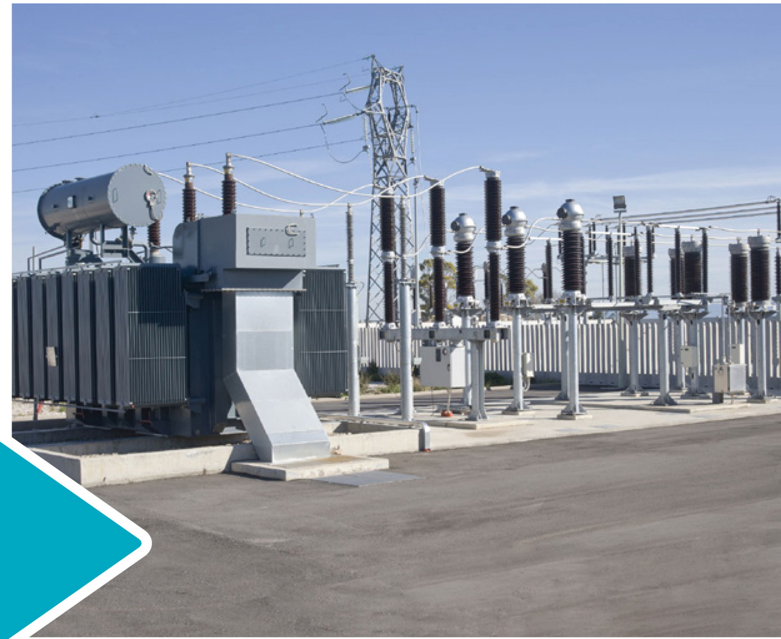
Transmission Substation Subestación de transmisión
