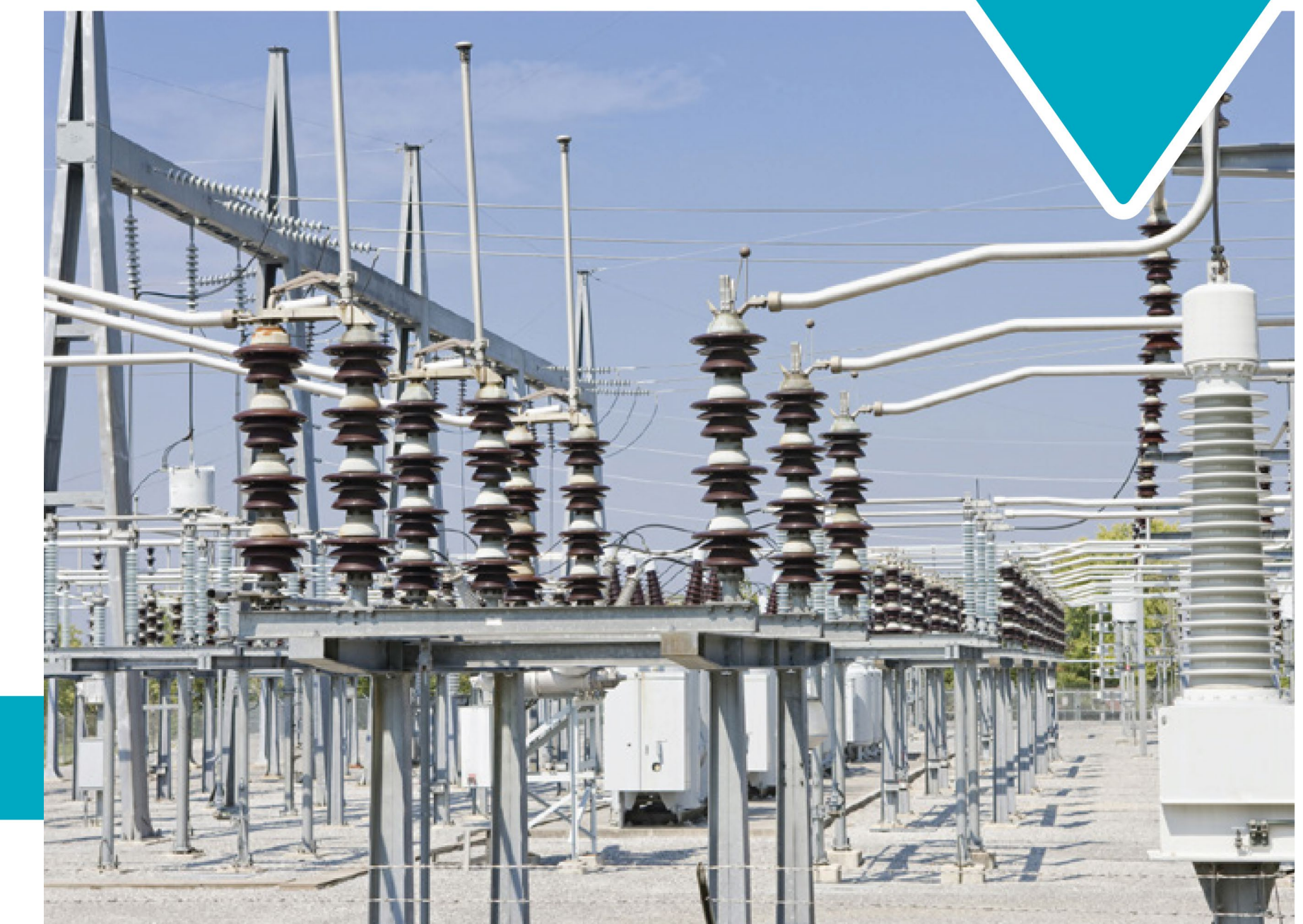
Distribution Substation Subestación de distribución
