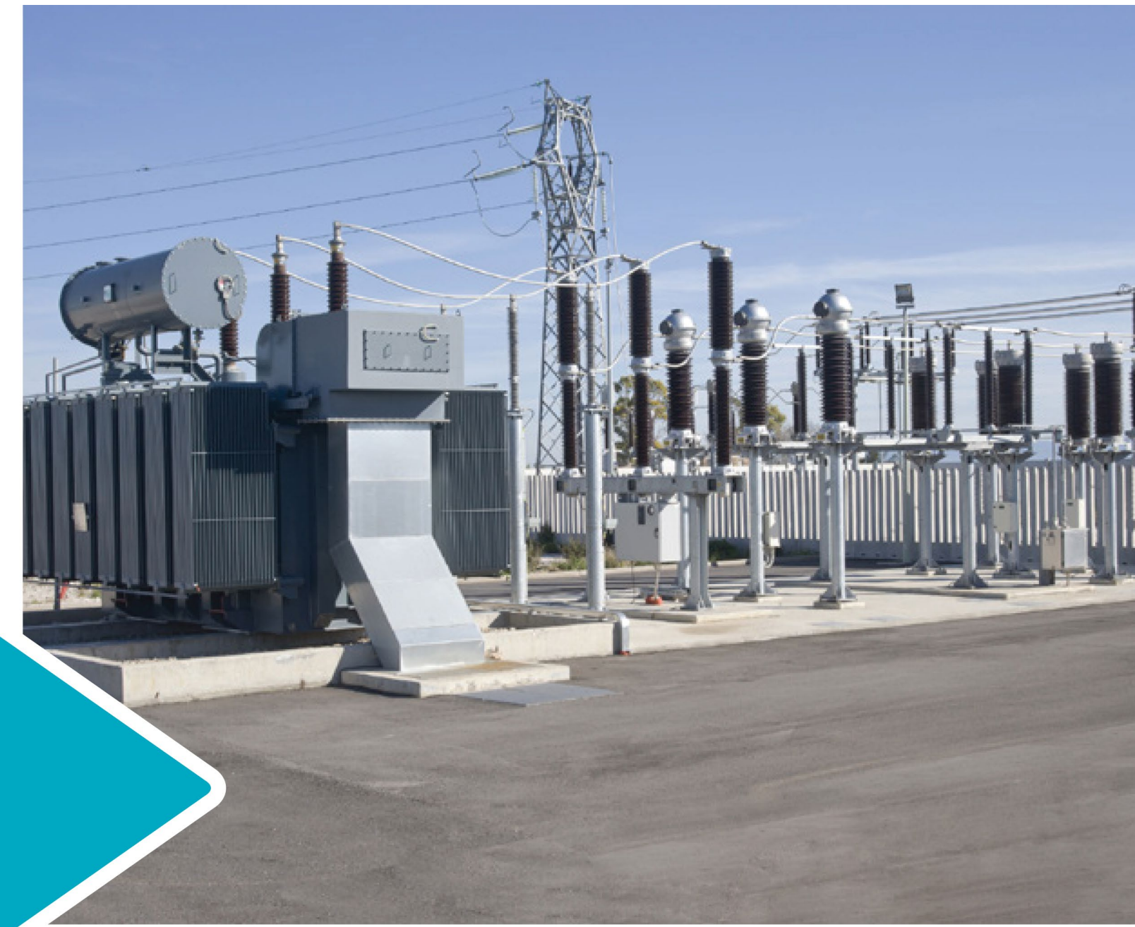
Transmission Substation Subestación de transmisión
