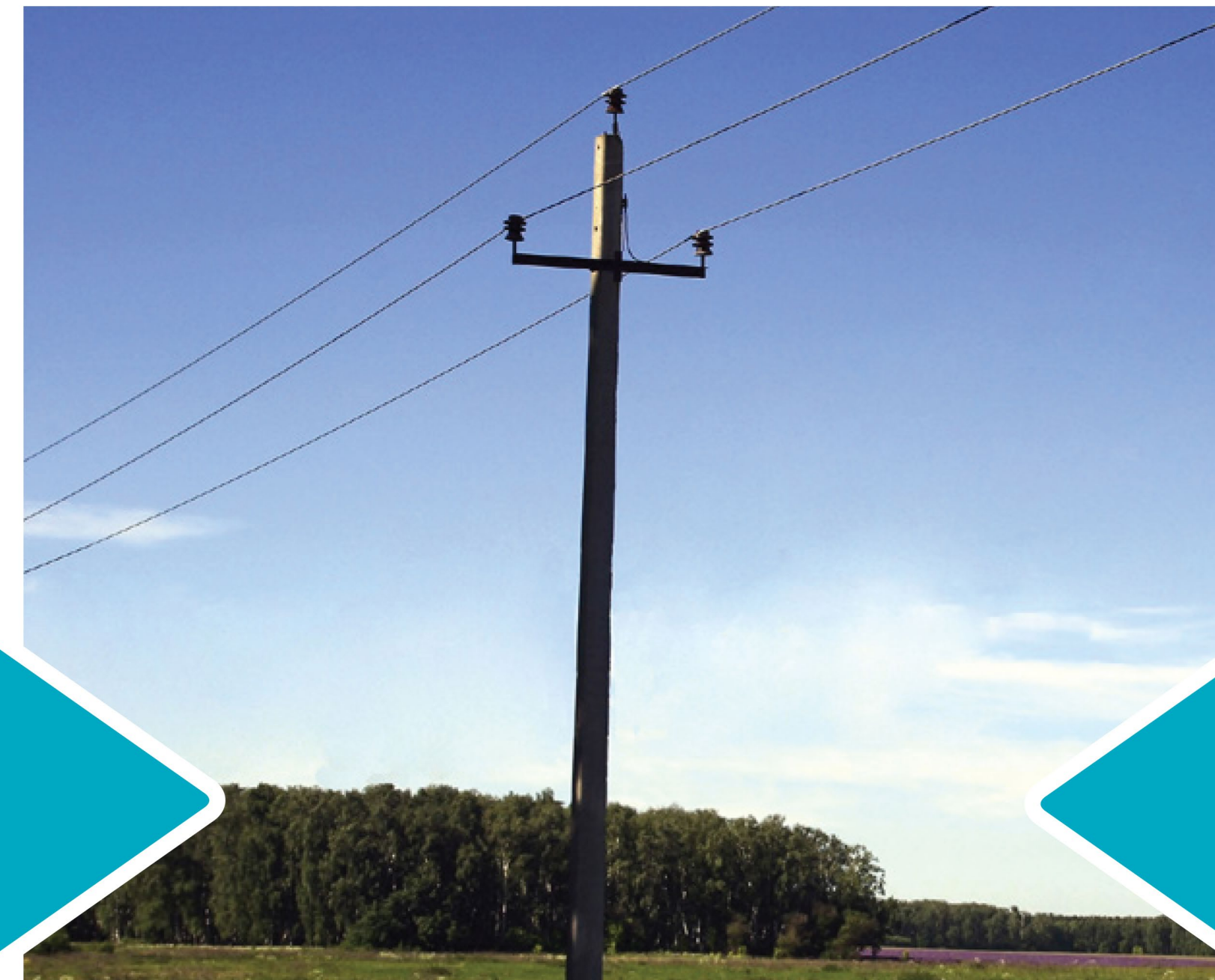
Distribution Lines Líneas de distribución
