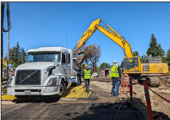
La tierra excavada se cargó en camiones para su transporte a un vertedero autorizado.
